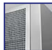
Équipement frigorifique en partie haute
